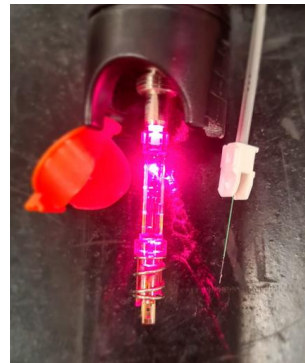
Fibra óptica rompida
